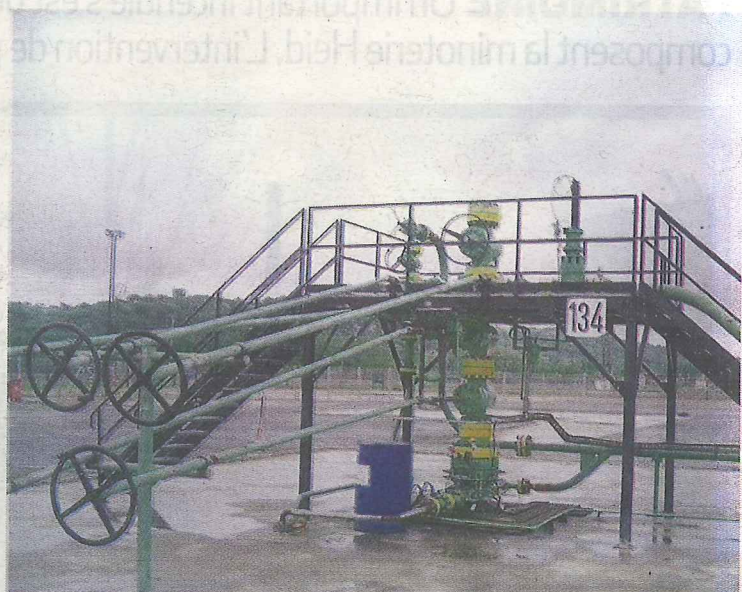
Les puits de gaz du cluster d'Arance, ultimes puits de Lacq fournisseurs de gaz, seront désormais gérés par Géopétrol. © D.R
