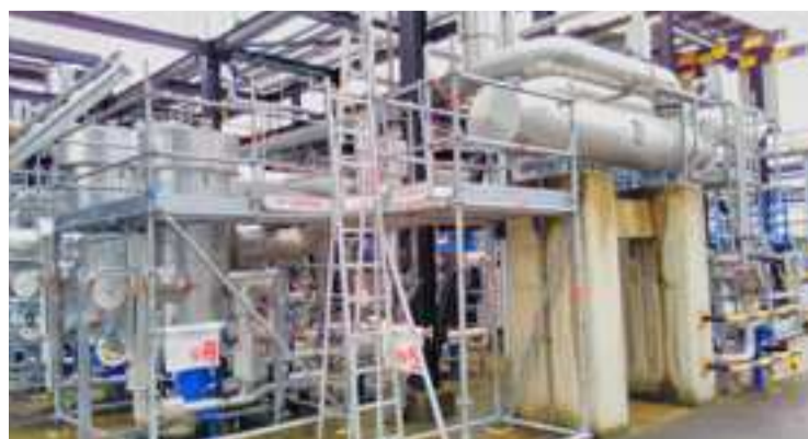
L'unité de traitement de gaz de la Sobegi est prête pour la maintenance. © DR
